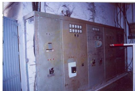
Dependència de risc especial amb instal·lacions elèctriques.
