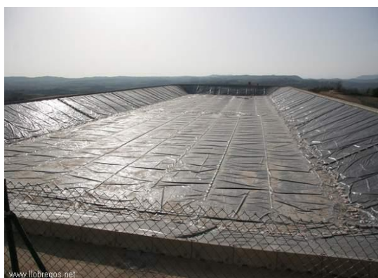
Bassa destinada a l'extinció d'incendis. Font: http://www.llobregos.cat .
