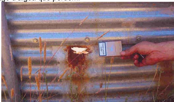
Fig 2.-Punt d'aigua deteriorat per la corrosió de les parets metàl·liques
