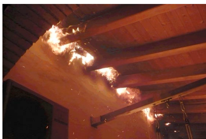
Propagació de l'incendi a la coberta per sobre de la paret de sectorització. Font: Bombers de la Generalitat de Catalunya
