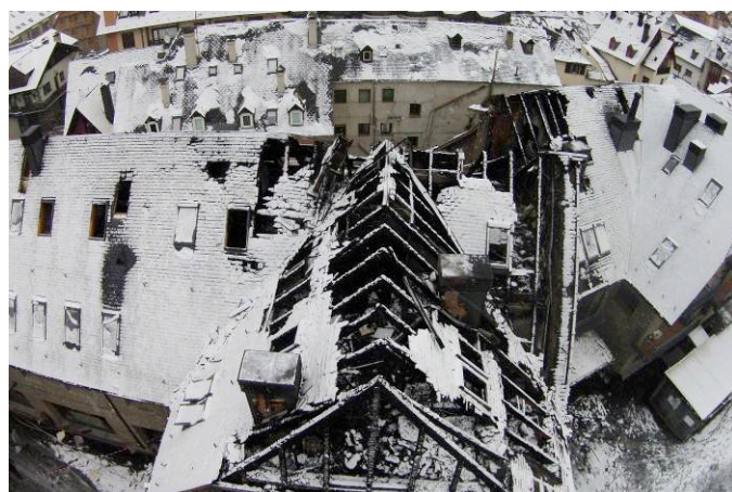
Imatge d'estructura de coberta en edifici d'habitatges sense sectoritzar Font: Pompiers Val d'Aran
