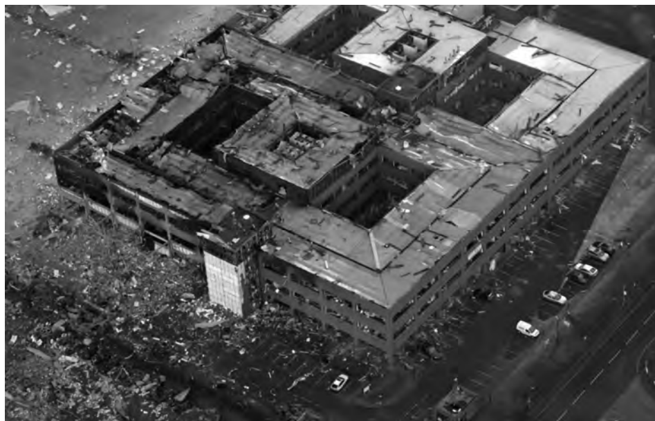
Imagen 3. Zona afectada de Buncefield.
