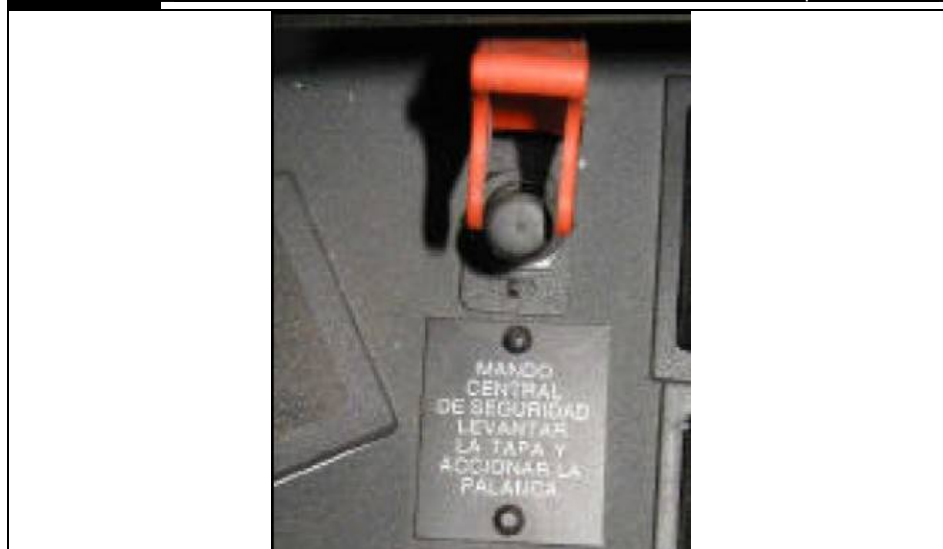
Figura 1.14 Comandament central de seguretat (autobusos IVECO), al costat esquerre de la butaca del conductor. Provoca el tancament de les vàlvules dels dipòsits
