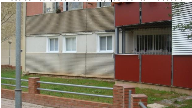
Imatge 14. Vista d'una planta baixa de l'av. de la Mediterrània amb finestres i balcó sense reixes, que faciliten l'accés a l'interior del domicili
