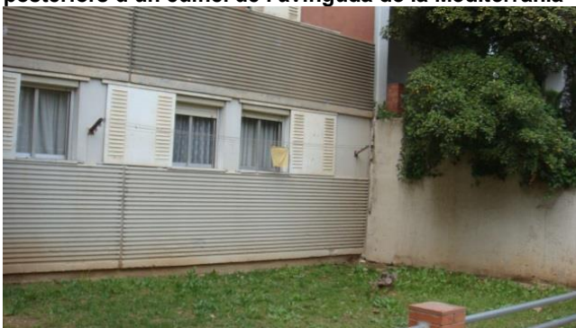
Imatge 13. Sòcol amb irregularitats en una de les façanes posteriors d'un edifici de l'avinguda de la Mediterrània
