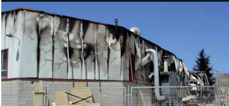
FIGURA 1.1. Zona circumdant d'un edifici industrial després d'un incendi
