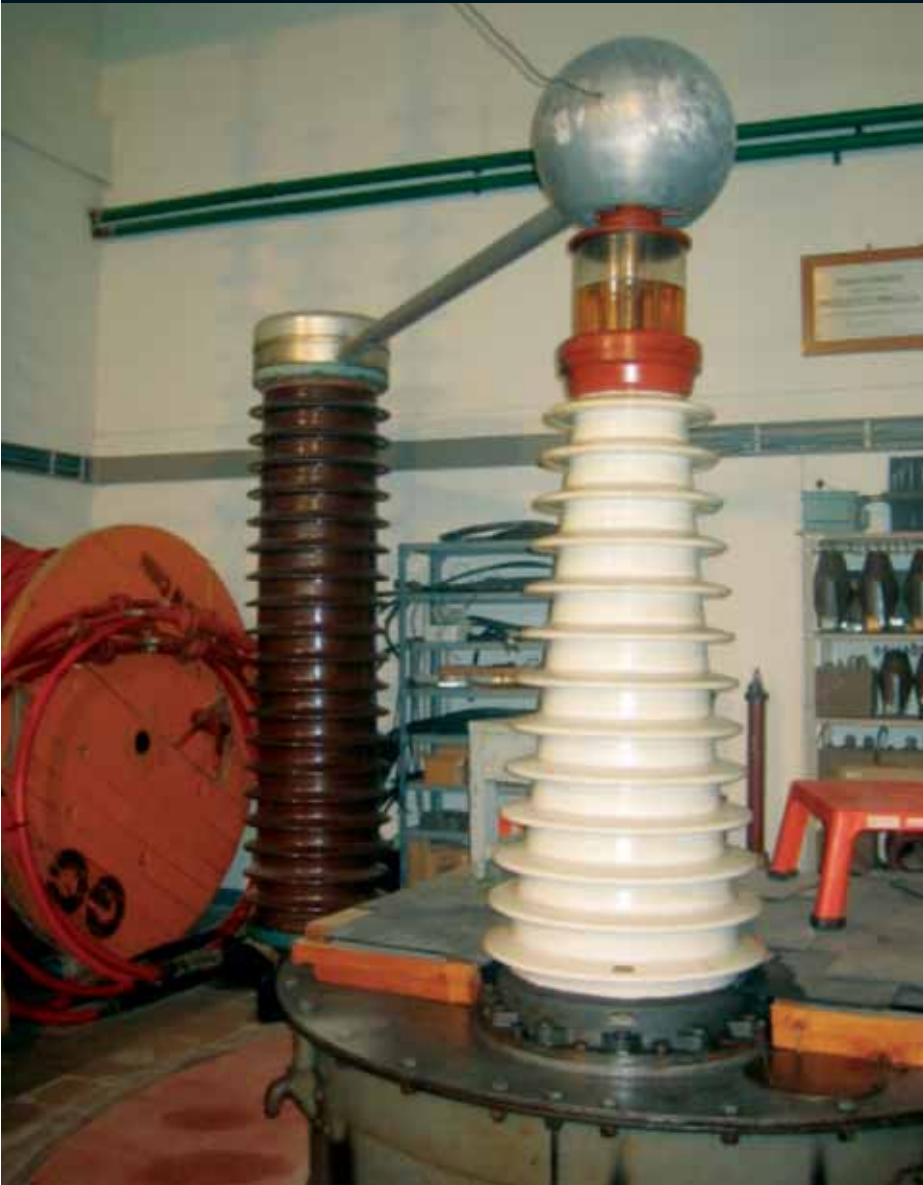
FIGURA 5.23. Transformador monofàsic d'assaig
