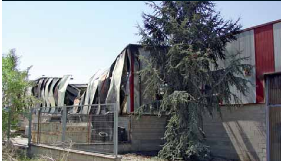
FIGURA 4.7. Exterior de la nau sinistrada, part posterior
