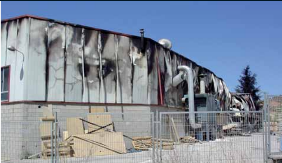
FIGURA 4.8. Afectació de dins a fora de la nau
