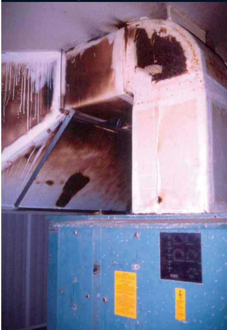
FIGURA 4.20. Conducte d'aspiració i climatitzador
