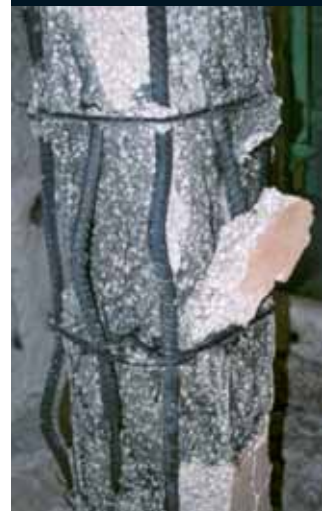
FIGURA 1.27. Fenomen de l'esclatament del formigó en un pilar sotmès a un foc estàndard durant un assaig de laboratori. L'existència dels estreps atenua mínimament el col·lapse (Kodur, 2005)
