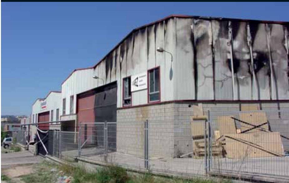
FIGURA 4.6. Exterior de la nau sinistrada, part frontal
