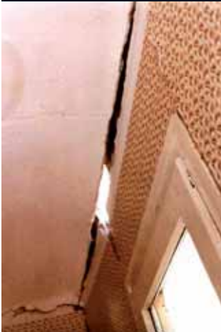
FIGURA 1.13. Efecte curiós d'una deflagració de gas on s'aprecia una finestra intacte i un forjat molt malmès
